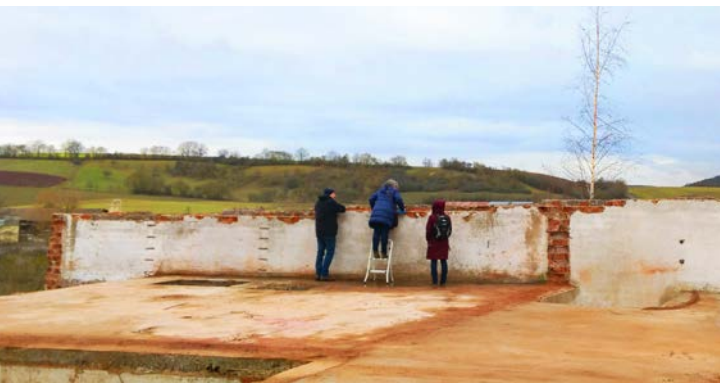
Mauer in Neuhoof an der Zenn, Bestands- und Schadensaufnahme des Architekturbüros Conn und Giersch (Fürth) (Foto: BLfD, Judith Sandmeier) Foto im Kreis: Entfernung von biogenem Bewuchs zur Sanierung des Fugen- und Mauerverbands (Foto: BLfD, Judith Sandmeier)
