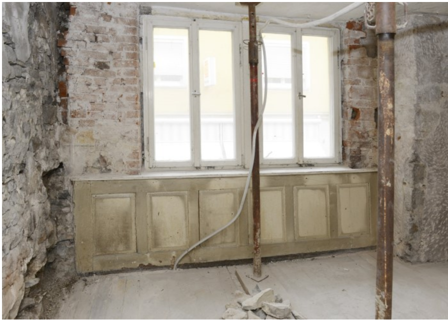
© (G. Gronauer) Sanierungsbedürftiger Wohnraum
