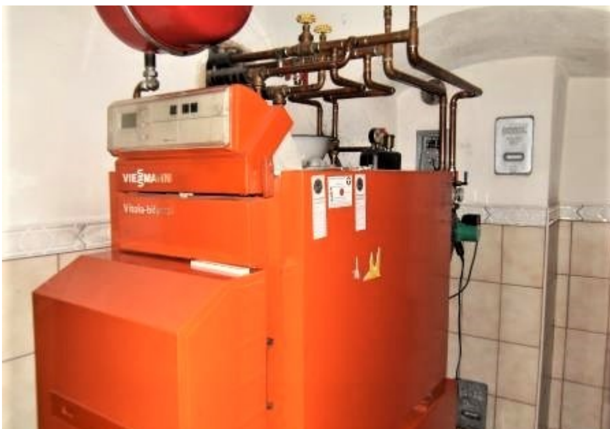
© (E. d. A.) Modernisierte Ölheizung
