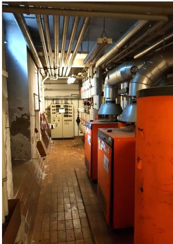
© (J. Butscher) Zeitgemäße Zentralheizung
