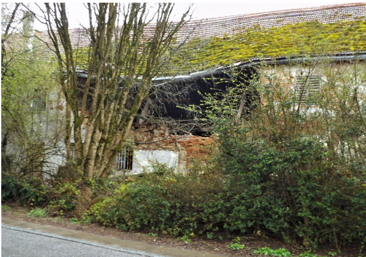
© (F. Goldbacher) Gebäudeschaden an der Gebäuderückseite
