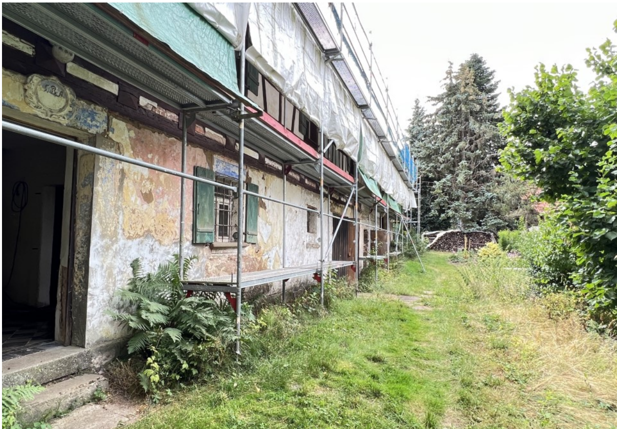
© (U. Böckl) Bauernhaus mit Notsicherung des Daches (Einhausung)
