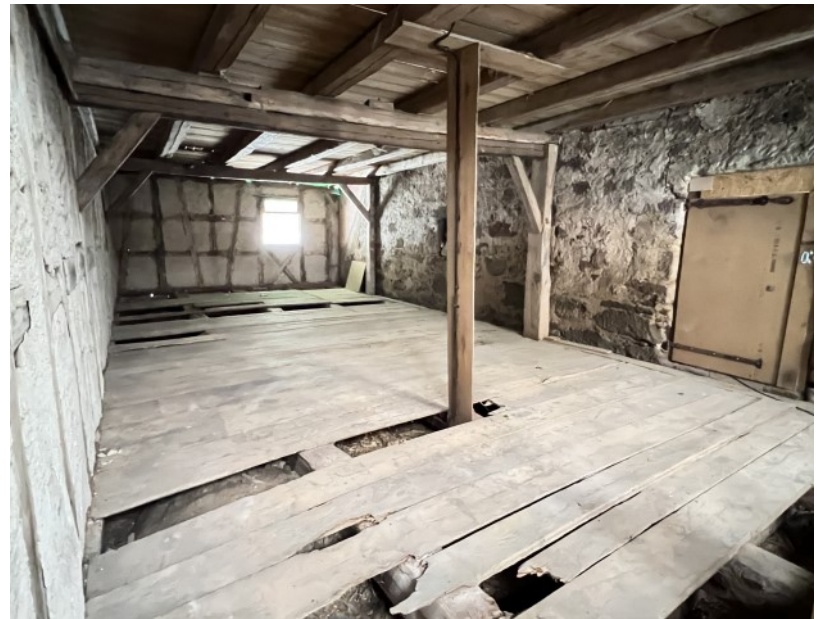
© (U. Böckl) Sanierungsbedürftiger Wohnraum im OG
