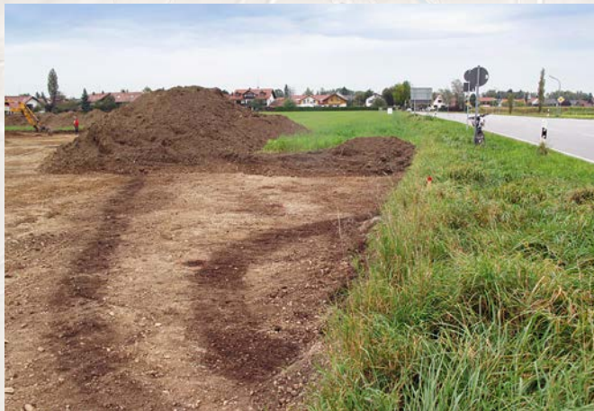
Aschheim, Lkr. München, Abtrag des Oberbodens. In der Regel zeichnen sich archäologische Befunde bereits knapp unter der Oberfläche als deutliche Verfärbungen ab (Foto: ADP GbR, 2015)
